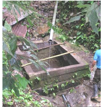
Cette installation mal faite a été installée par les autorités de la ville de Puyo. Il n'y a presque pas d'eau!
